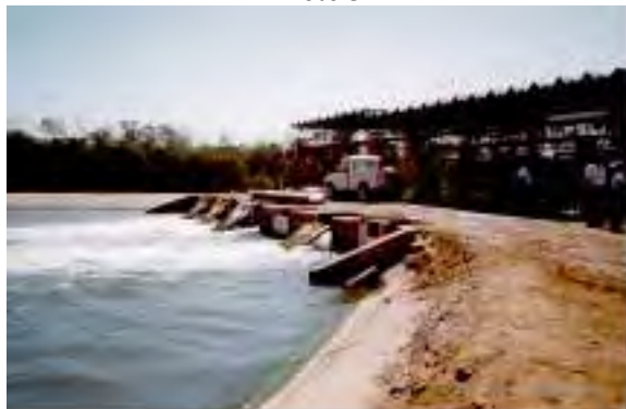
Estación de bombeo de la finca C.I. Océanos S.A.
